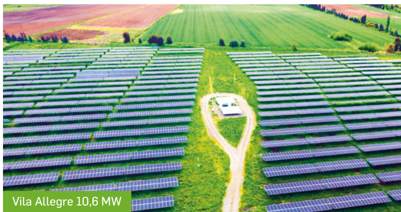
Střešní elektrárna Svijany
